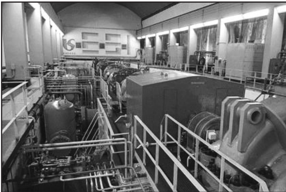
Figura 5 Estação Elevatória de Água Bruta Santa Inês. Sistema Cantareira/São Paulo. Fonte: SABESP (Companhia de Saneamento Básico do Estado de São Paulo).
